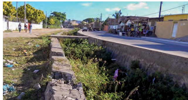
FIGURA 26 Canal Farias Neves: Revestimento danificado.
