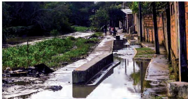
FIGURA 25 Rio Tejipló: Áreas marginais degradadas.
