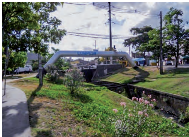
FIGURA 19 Travessia certa de tubulação sobre o Canal do Cavouco.
