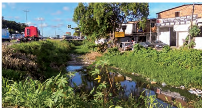
FIGURA 27 Canal Guarulhos: Trecho não revestido.
