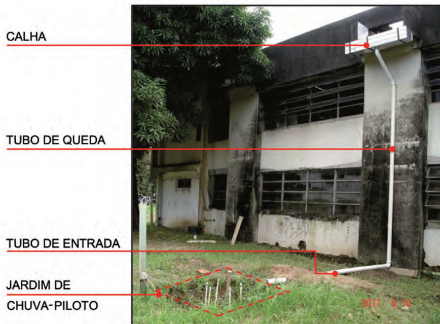
FIGURA 25 Conjunto para captação das águas superficiais do telhado para o jardim de chuva-piloto da UFPE
